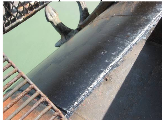
Detalhe da chapa de reforço no escovem
