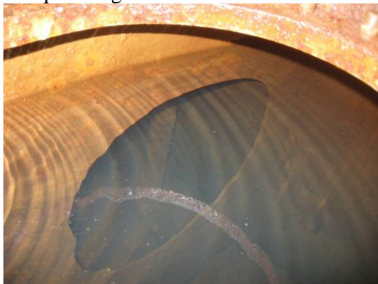
Tanque de água doce
