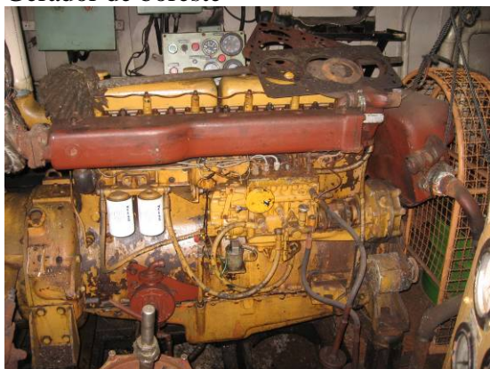
Gerador de boreste
