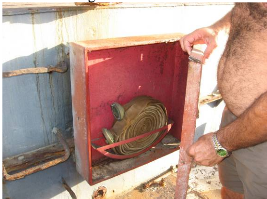
Caixa de mangueira de incêndio de ré
